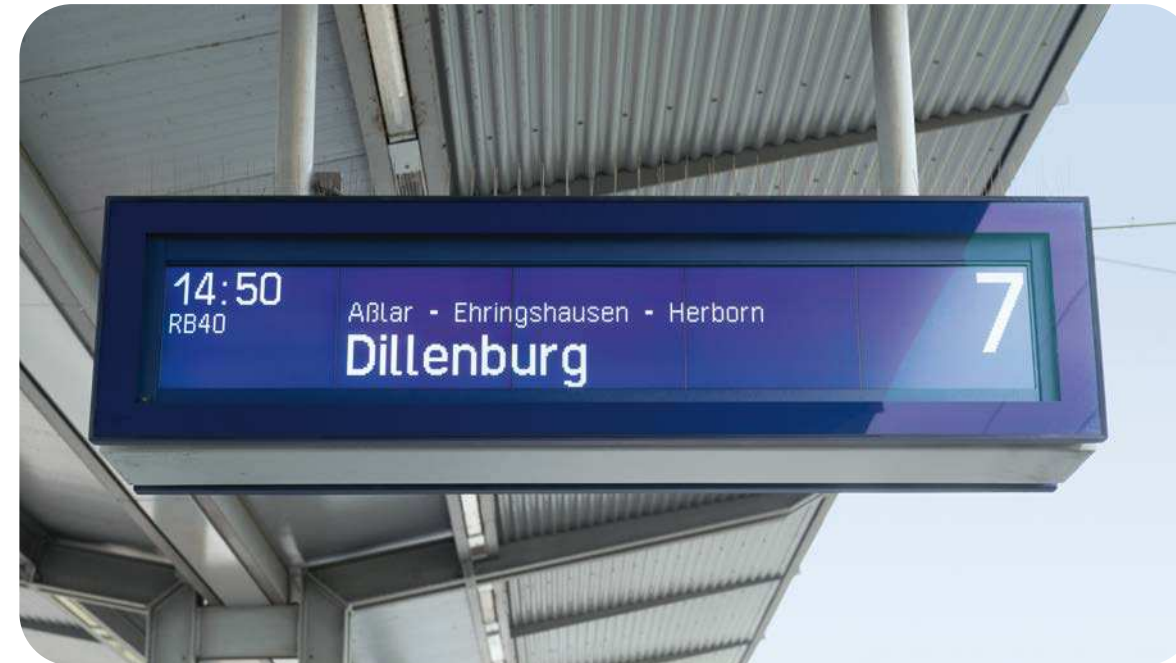
Abbildung 35: Digitale Fahrgastinformationsanlage (DFI) in Wetzlar (Foto: R. Städtler)
