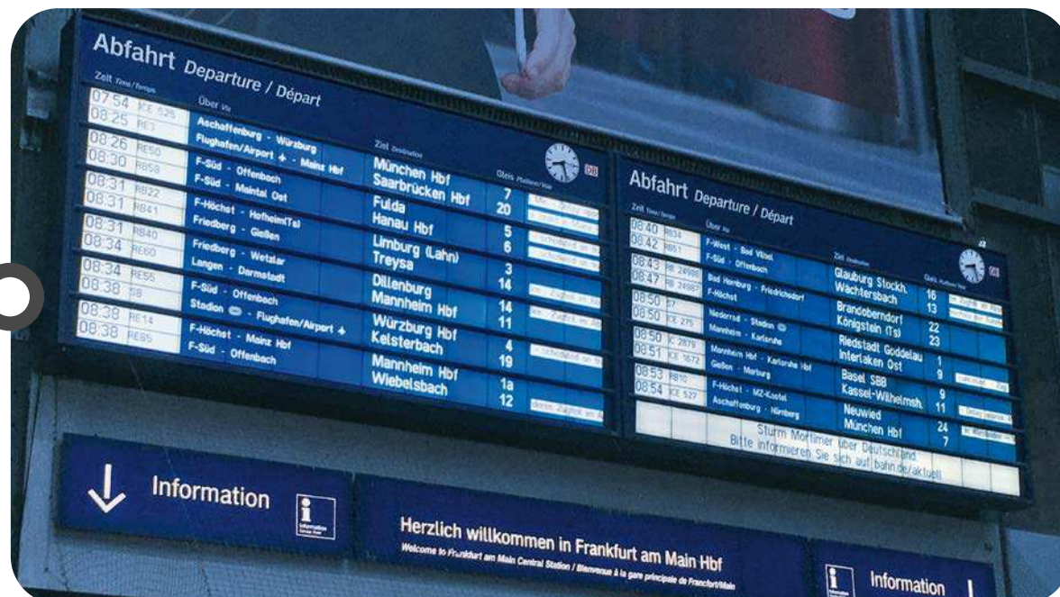
Abbildung 36: Zentrale Fahrgastinformationsanlage (FIA) im Hauptbahnhof in Frankfurt (Foto: RMV)
