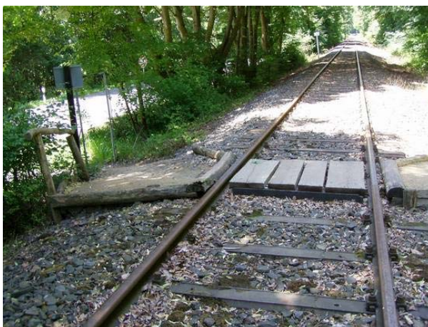
Abbildung 14: BÜ km 1,95 „Backofenschneise“ ohne technische Sicherung
